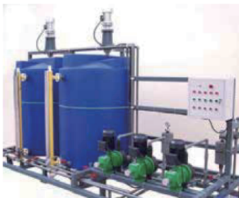
二氧化氯发生器 Chlorine Dioxide Generator
