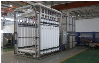
超滤系统 Ultrafiltration System
